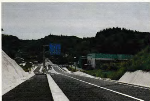
歪な線形だった県道8号竹田五ヶ瀬線(神原玉来線)の門田交差点(入田)付近はスッキリとした形に変貌を遂げた。交通安全の面でも効果を期待。
